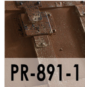
Craquelado Óxido / Cracked Rusty
