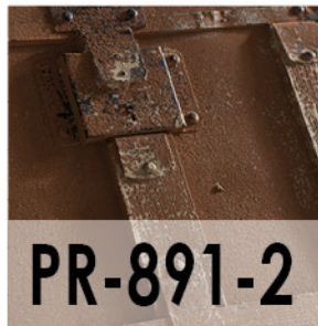
Craquelado Óxido / Cracked Rusty
